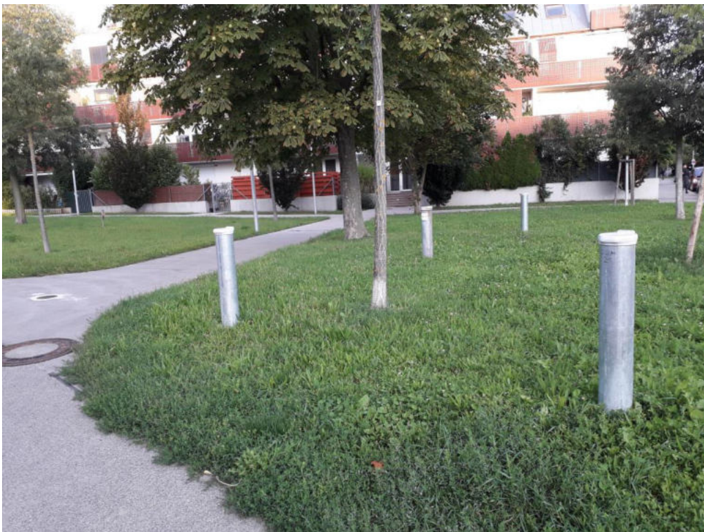
Fertig errichtete Pegel GW20, 21,22 (oberflur) sowie GW23 (unterflur) Im Zentrum: Bestandspegel GW13
