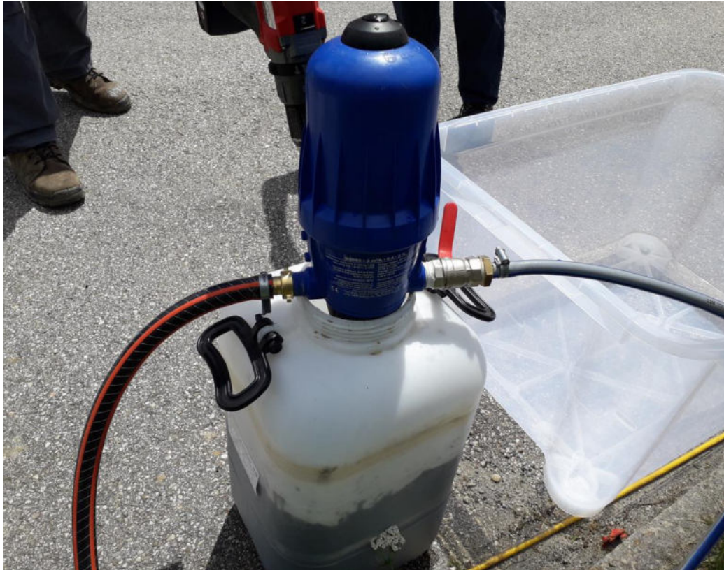
Abb. 19: Pumpenvorrichtung für Eisendotation in GW08
